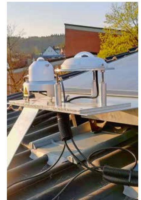
Einstrahlungsmessgerät (links) und Wolkenkamera (rechts) wurden vom Partner Fraunhofer ISE im Projekt PV 2 WP auf dem Dach eines Einfamilienhauses installiert, um die Solarleistung vorherzusagen und so die Wärmepumpe effizienter einzusetzen zu können
