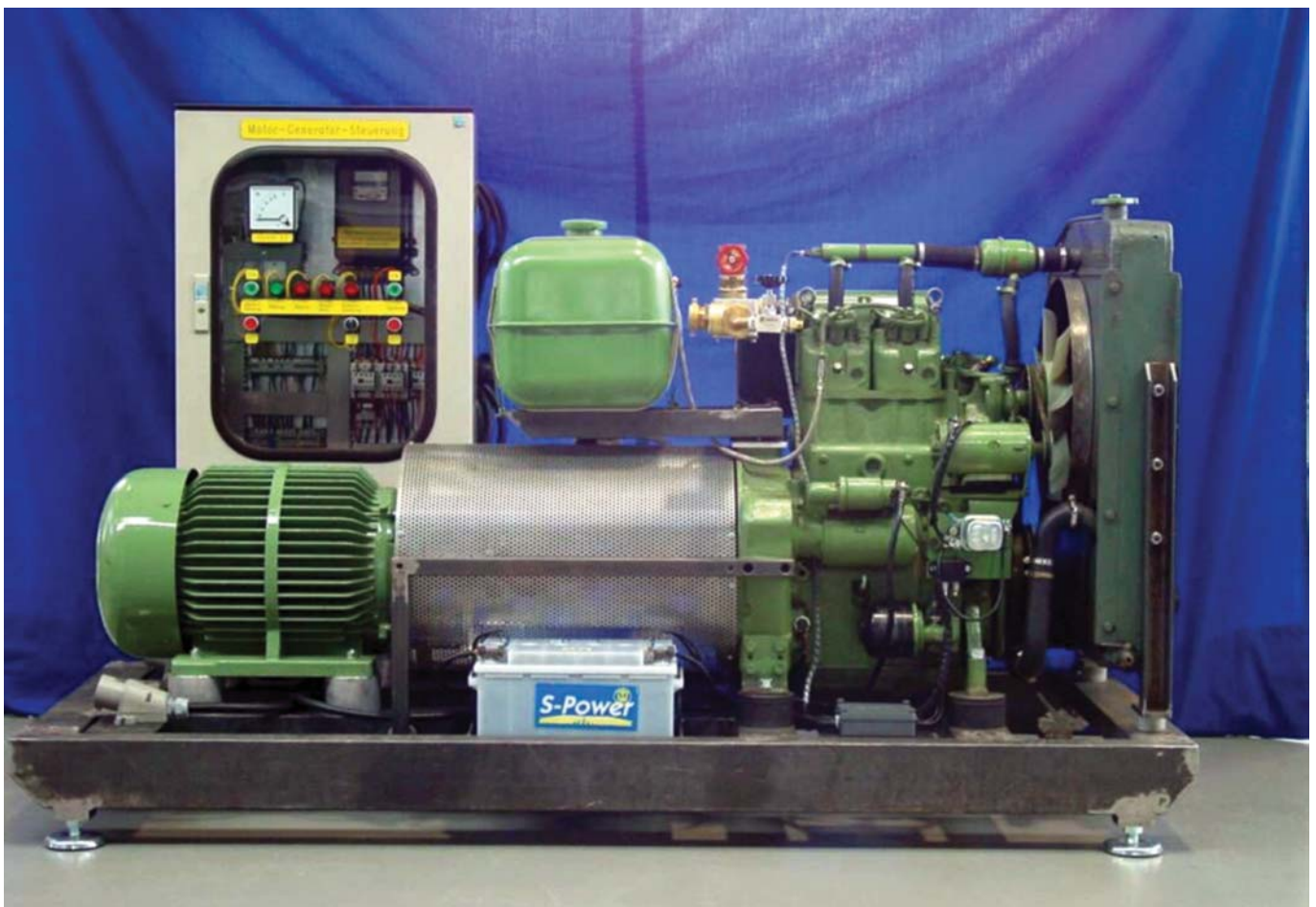
Abb. IV-14.3: Diesel-Gasmotor mit Asynchrongenerator
